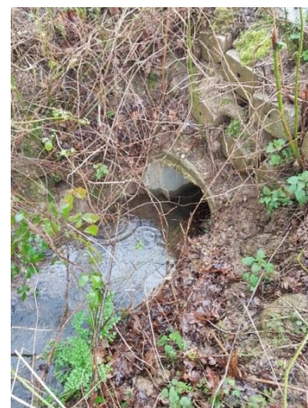
Buse sous passage agricole
