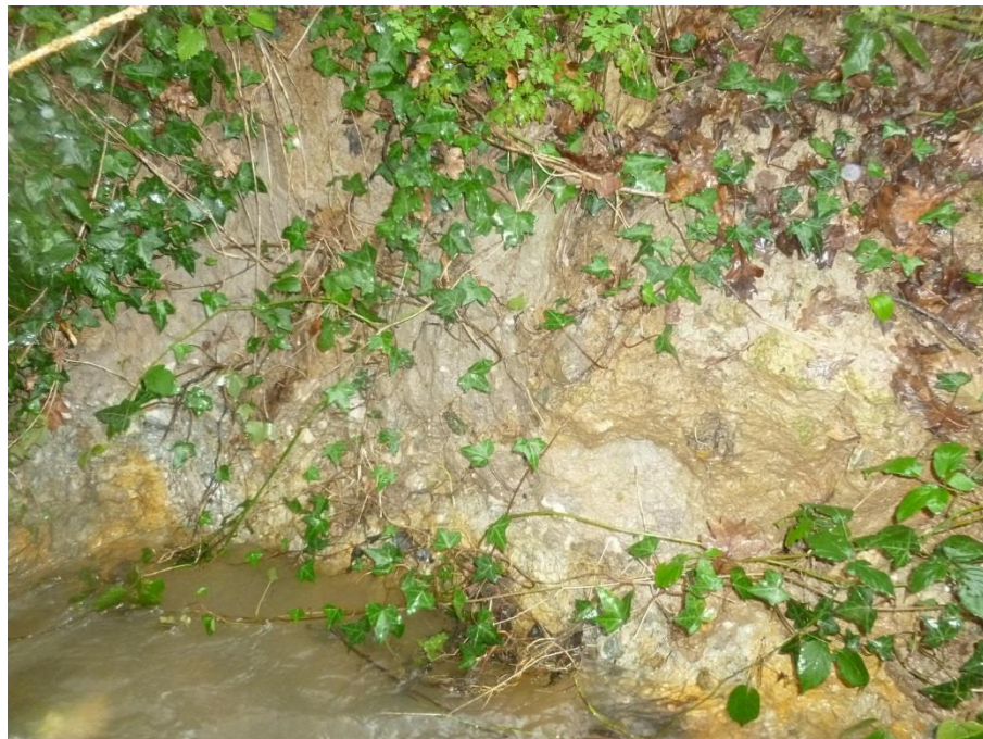
Encoches d'érosion à divers endroits du tronçon étudié
