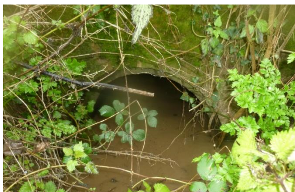
Buse béton envasée en limite de la zone d'étude
